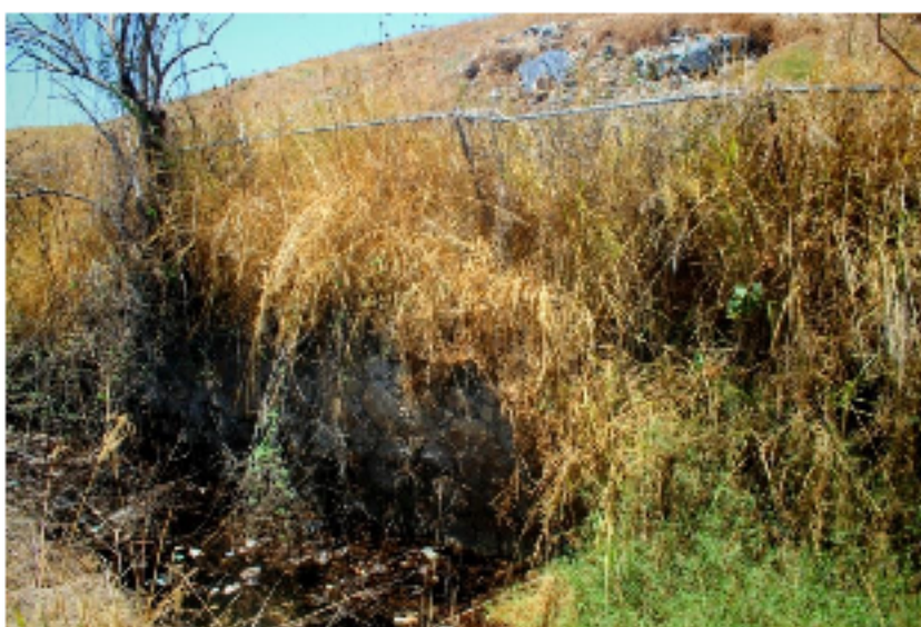
Foto: canal de lixiviados fuera de la cerca perimetral del vertedero
