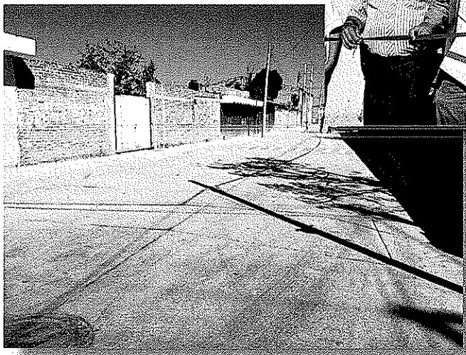
Arranque de Obra en la Calle Plan de Guadalupe en la Delegación San José del 15.
